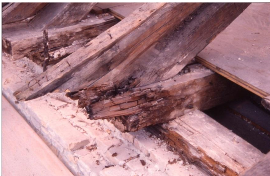
Figur 35 Typisk skada till följd av otätt tak. Vatten har runnit ned till takfoten under en längre tid och rötsvamp har angripit sparrens fot; en punkt som är avgörande för konstruktionens stabilitet.
