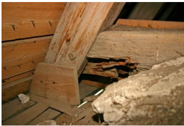
Rötskada. Foto: Carl Thelin
