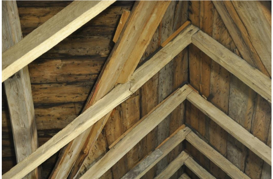
Figur 40 Skada till följd av olämplig belastning. En stor punktlast har kommit att belasta en av sparrarna, kanske genom att man har byggt korsarmar på en befintlig kyrka och låter en av de befintliga sparrarna ta en stor koncentrerad last. Foto: Daniel Eriksson.
