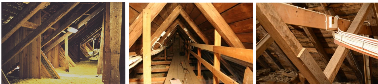
Figur 32 Förändringar som påverkar vindsrummet. a) Lysrörsinstallationer (bilden visar också restaureringsåtgärder). Foto: Ylva Sandin. b) Handledare och inspektionsbrygggor. Foto Ylva Sandin. c) Okänslig kabeldragning i medeltida konstruktion. Foto: Robin Gullbranson
