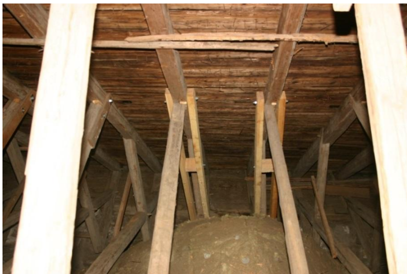
Figur 52 Nya delar insatta bredvid originalkonstruktionen. Åtgärden påverkar intrycket av den gamla takkonstruktionen som en lastbärande struktur med exceptionell hållbarhet. Det man ser efter åtgärd är en konstruktion som har behövt hjälp, snarare än en konstruktion som klarar att bära last i många hundra år. Foto Carl Thelin.
