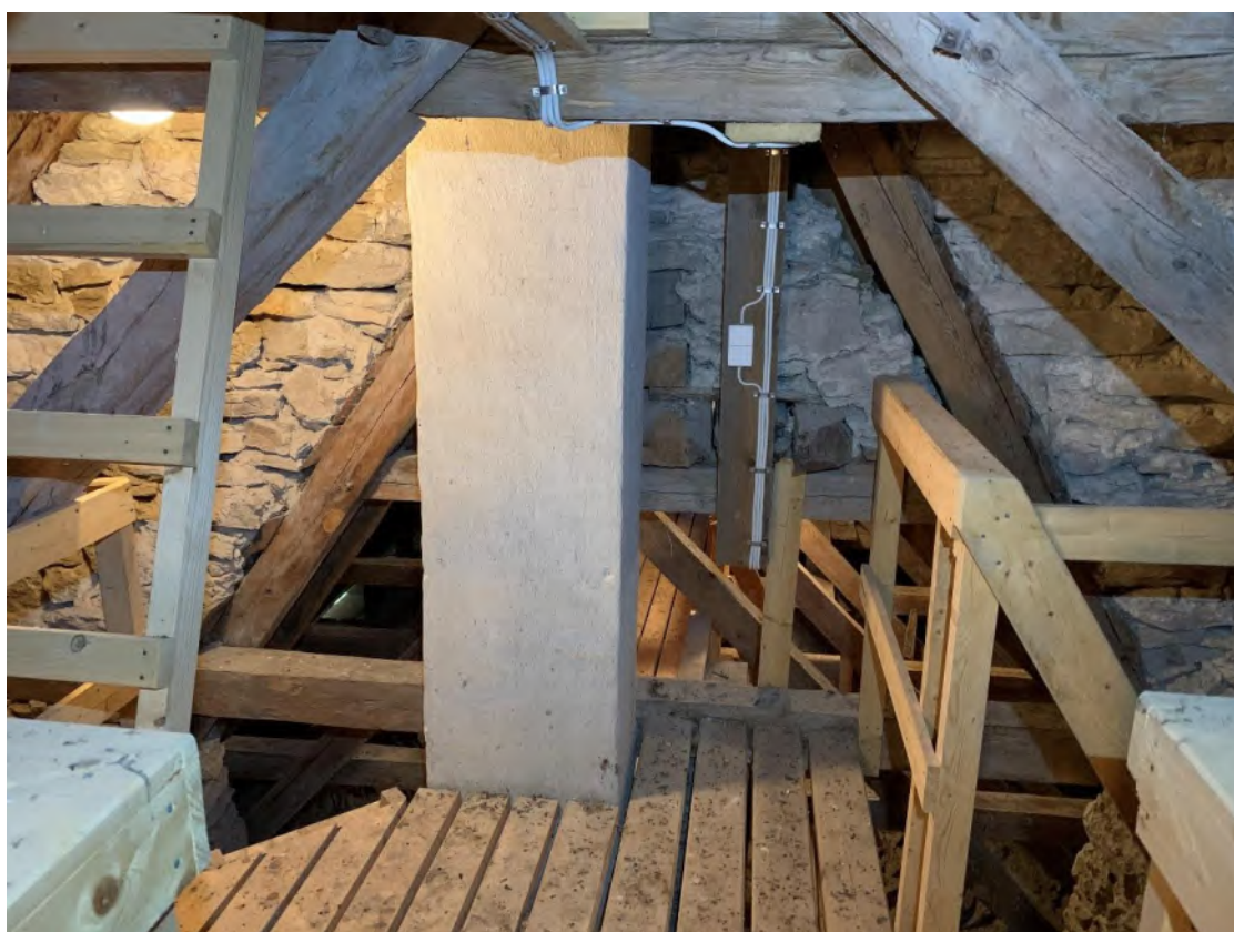
Triumfbågmurens gavelröste samt skorstensstocken sett från långhusvinden. Öppningen mellan vindarna är till sin övre del igensatt i samband med sänkningen av yttertaket. Foto JL 2020.
