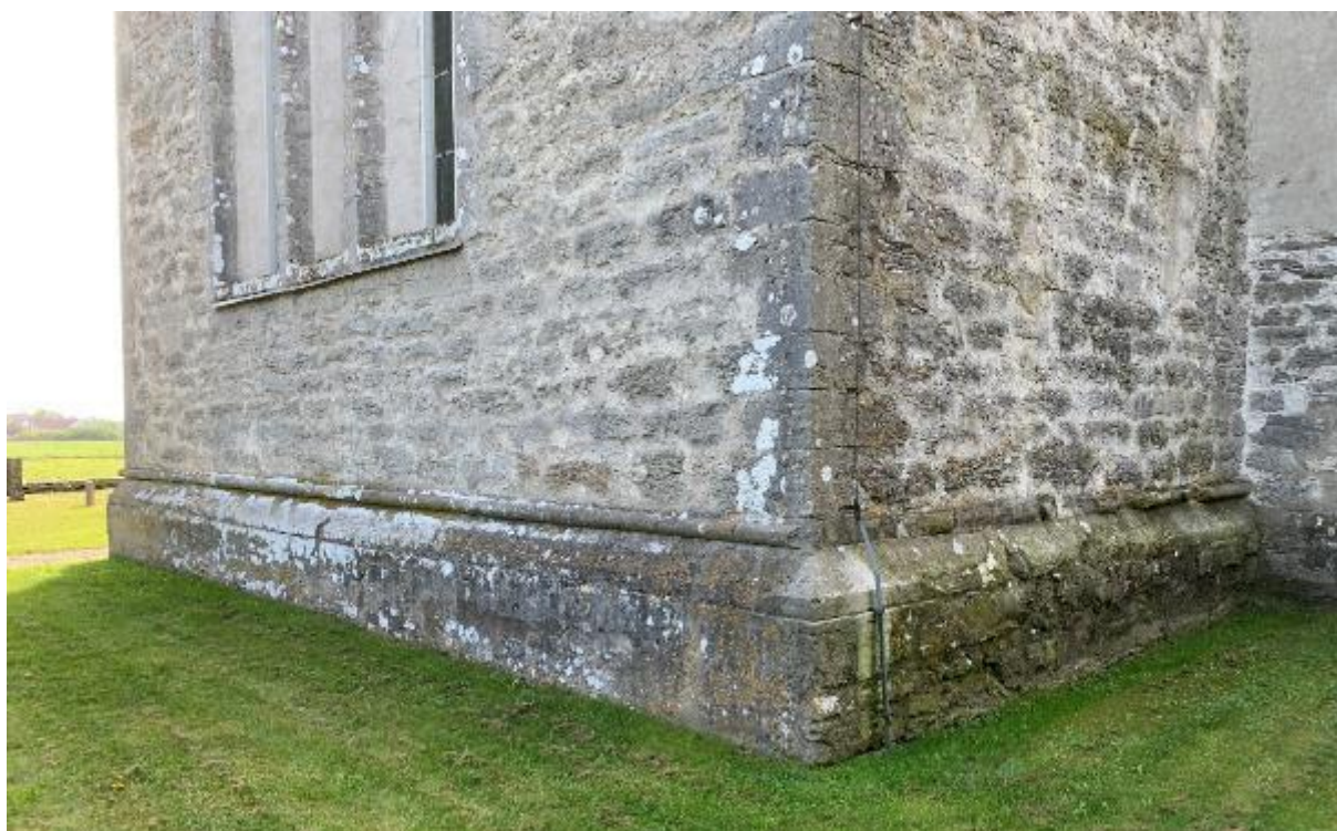
Sockeln på korets östra och norra sidor. Norra sidans sockel uppvisar spår av brand. Foto JL 2020.
