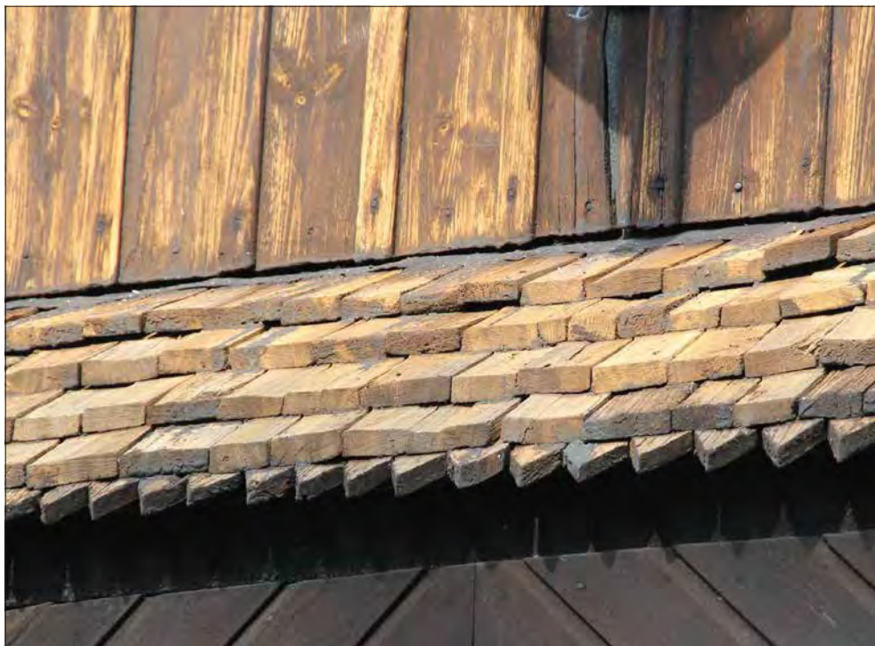
Säby klockstapel. Kluvna expån på taket över klockstapelns entré.
