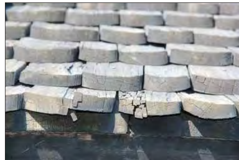
Sura gamla kyrka. Kluwna takspån från 2003 med rötskador och sprickbildning.
