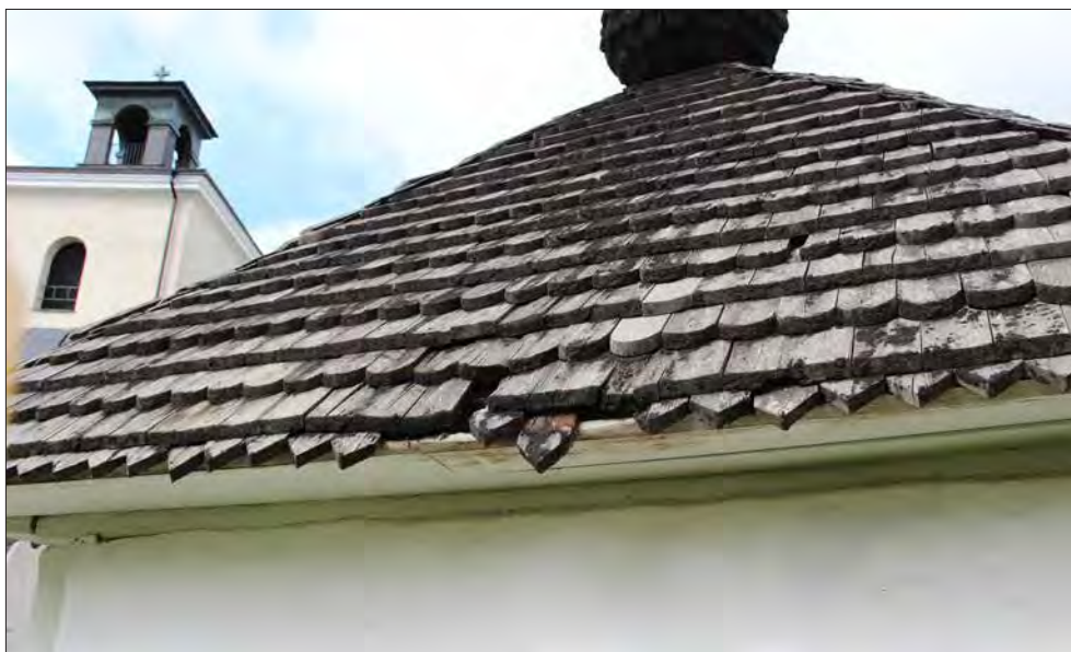
Tillberga kyrka. Rötskador i norra sticluckans spåntäckning.
