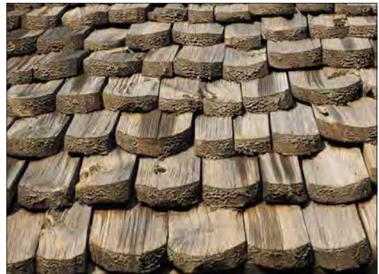
Kärrbo kyrka. Spån på sakristians östra takfall.
