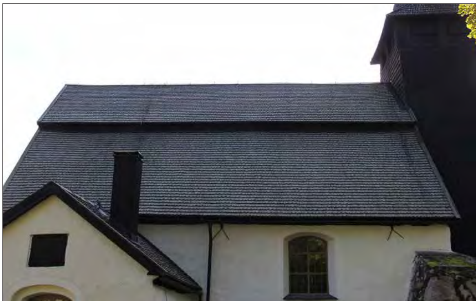
Kungs-Barkarö kyrka. Långhusets södra takfall med klyvda och tjärdoppade spån från 1990.
