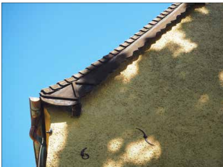
Fors kyrka. Vindskivespån på södra korsarmen.
