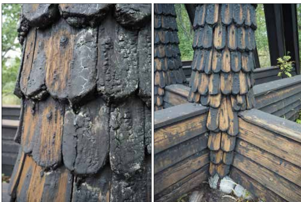
Kila klockstapel. Älderdömliga spån på en av hjärtstolparna (t.v.). Notera de spetsiga spånen längst ner (t.h.).
