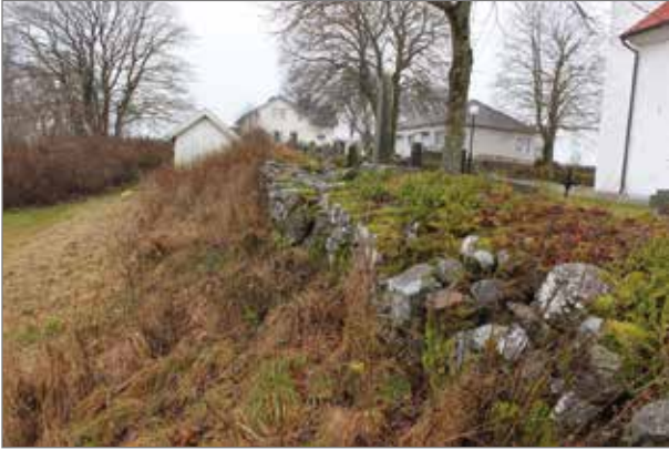
I den södra muren har några stenar tryckts ut eventuellt på grund av att trädens rotsystem har tryckts på.
