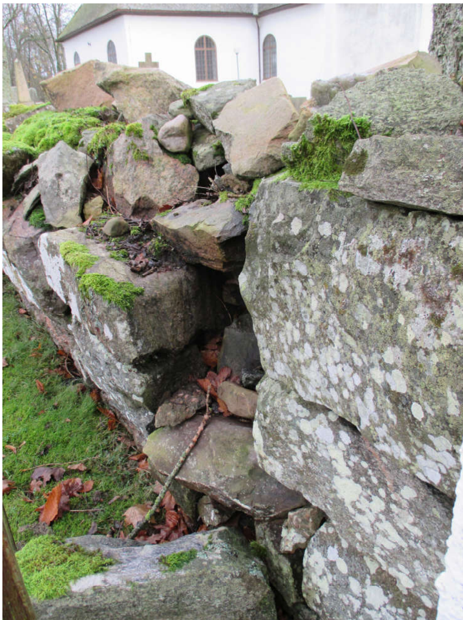
Muren har kalvat under lång tid och nu rasar stenar ur. Muren behöver plockas ned till grundstenen och byggas upp på nytt.
