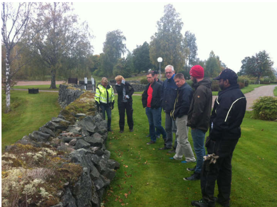
Projektmedarbetarna besiktar och diskuterar ett skadeområden på kyrkogårdsmuren vid Rämmens kyrka, Filipstads församling.
