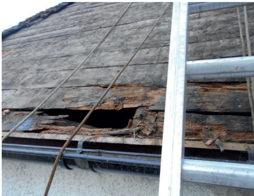
Underbrädningen på sakristietaket var sämre än befarat och flera bräder måste bytas ut i sin helhet eller till viss del. Här ett skadat parti nära långhusväggen. Foto Hälsinge Takspån AB 20161005.
