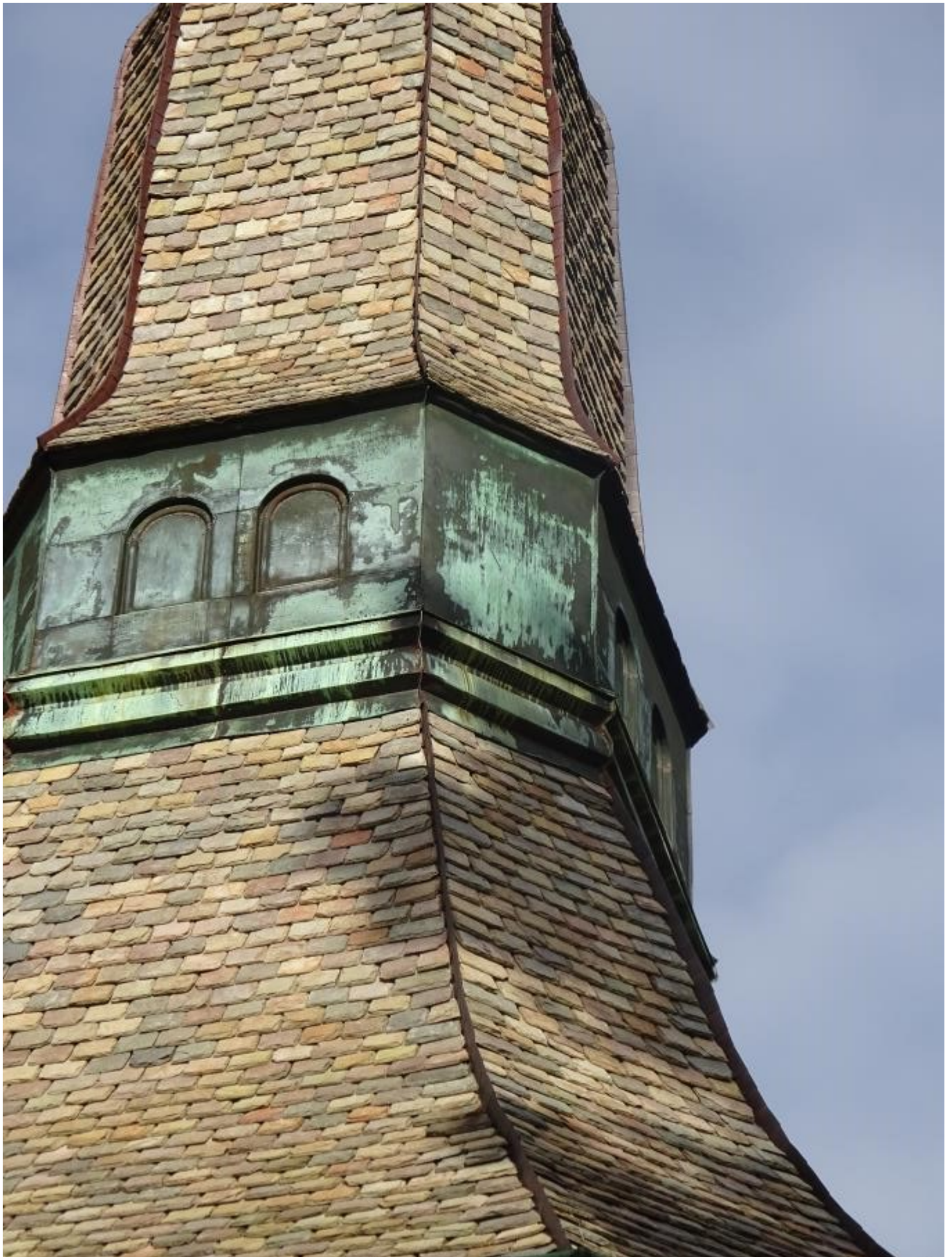
Trefaldighetskyrkan i Arvika. På tornets snednockar har skiffern anslutits mot en falsad kopparplåt. Som ger oönskade vertikala linjer.
