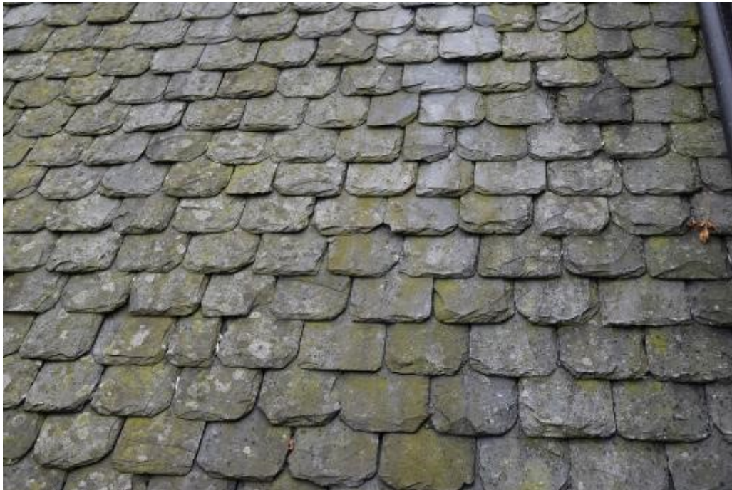
Bilden ovan visar ett skiffertak som inte är fackmannamässigt utfört. Stenen ligger med för litet täck, har inte rätt förskjutning på skarvar och många felvända plattor.
