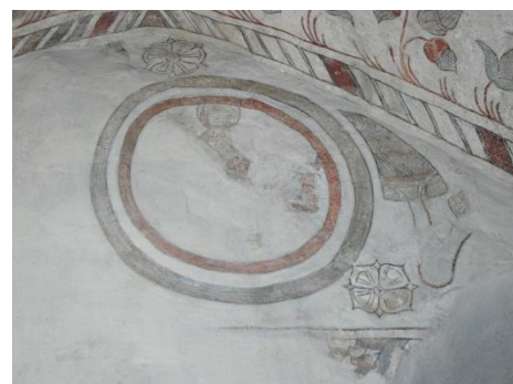
Korets norra vägg, skadad figurrundel.
