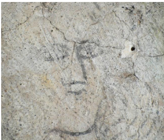
Norra triumfbågmuren, detalj. Borrhål och sprickor i putsen.
