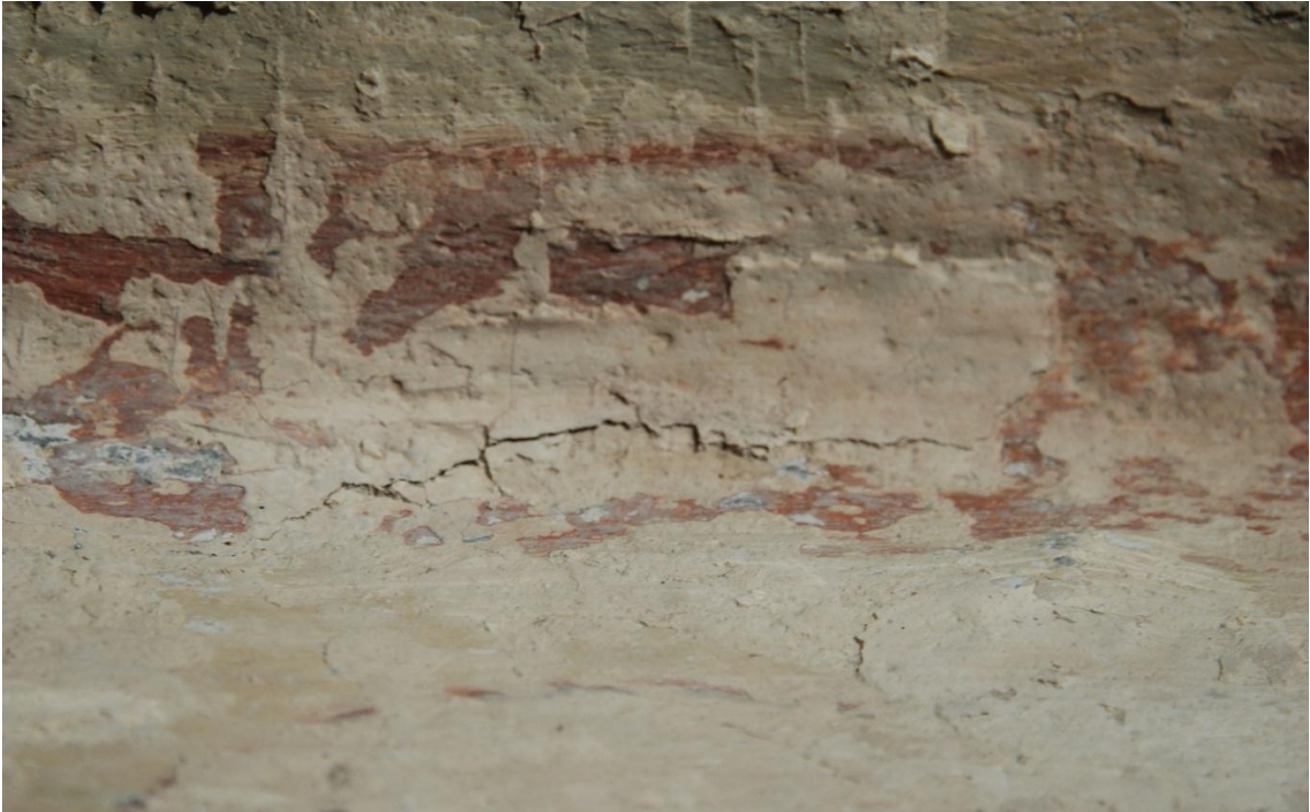
Bild 7: sprickor i putsen
