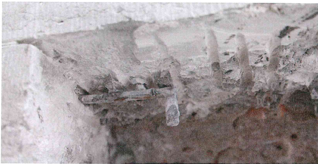
Den rostiga järnkramlan syns i urbilningens överkant.
