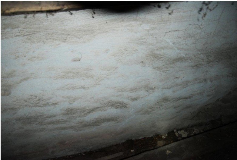
Bild 10: utsidan av korets nordvägg, sedd uppifrån. Den medeltida putsen är i stort sett intakt.
