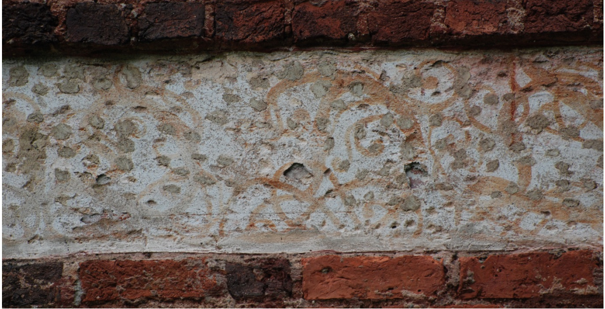
Del av textbandet på östgaveln, med mörkfärgade ifyllningar och bortfall i putsen.
