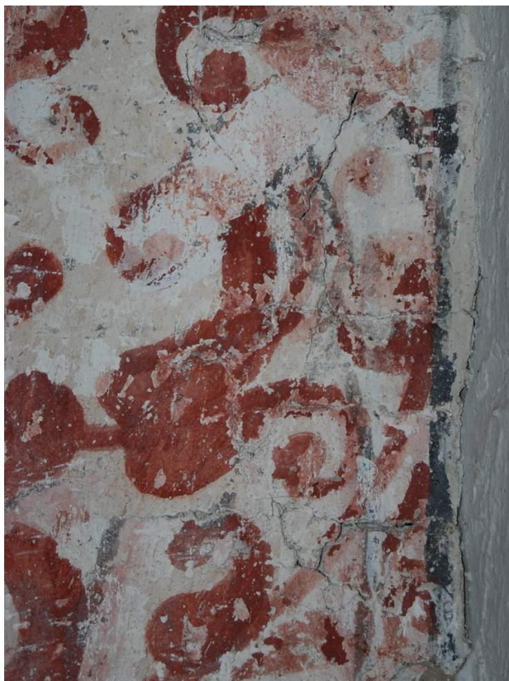
Bild 5: Öppna sprickor i putsen på sydöstra valvanfängen i koret.
