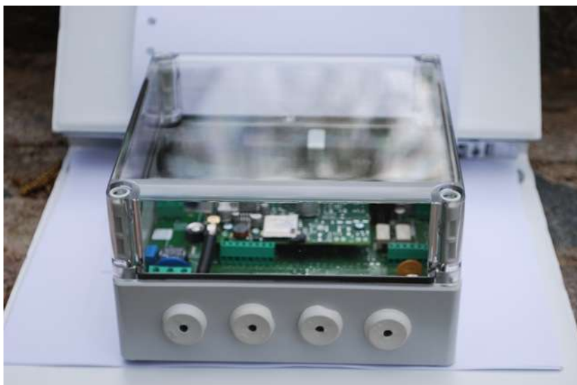
Fig. 3: Styrbox monterad under golvet nedanför predikstolen.
