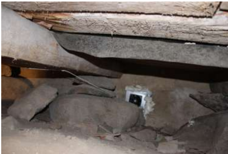
Fig. 2: en av fyra utblåsfläktar monterade med fogsium på insidan av sockelventilernas ventilationsgångar.
