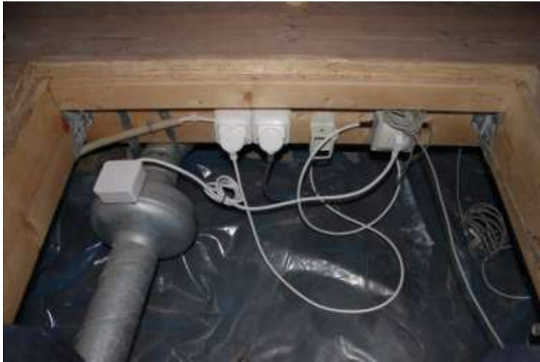
Fig. 4: Bild genom manluckan i kyrkorummets nordöstra del. Till höger i bild i kontaktuttaget till den gamla fläktinstallationen har installerats ett relä som styrs av DryVents styrenhet.
