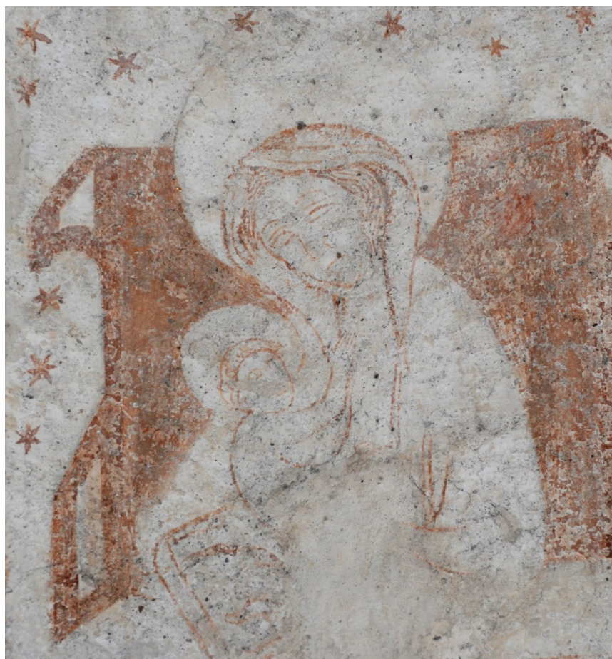
Västra korvalvet, västra valvkappan, detalj av den tronande Maria med barnet. Putsen är grovt magrad med mörk småsten. Färgen har släppt och stenarna lyser igenom som svarta prickar. Bortfallen är identiska med vad som syns på bilder tagna efter konserveringen 2011, då dessa bortfall alltså inte retuscherades.
