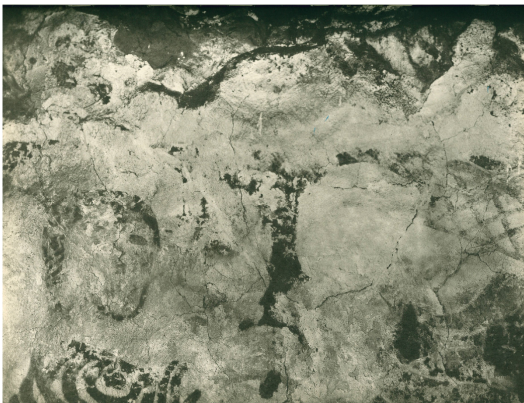
Norra långhusväggen, mellan valven. Ovan översiktsbild nuläge, nedan Borelius bild (Borelius 1956). Ansiktet i den vänstra delen av bilden har skadats något efter 1956.
