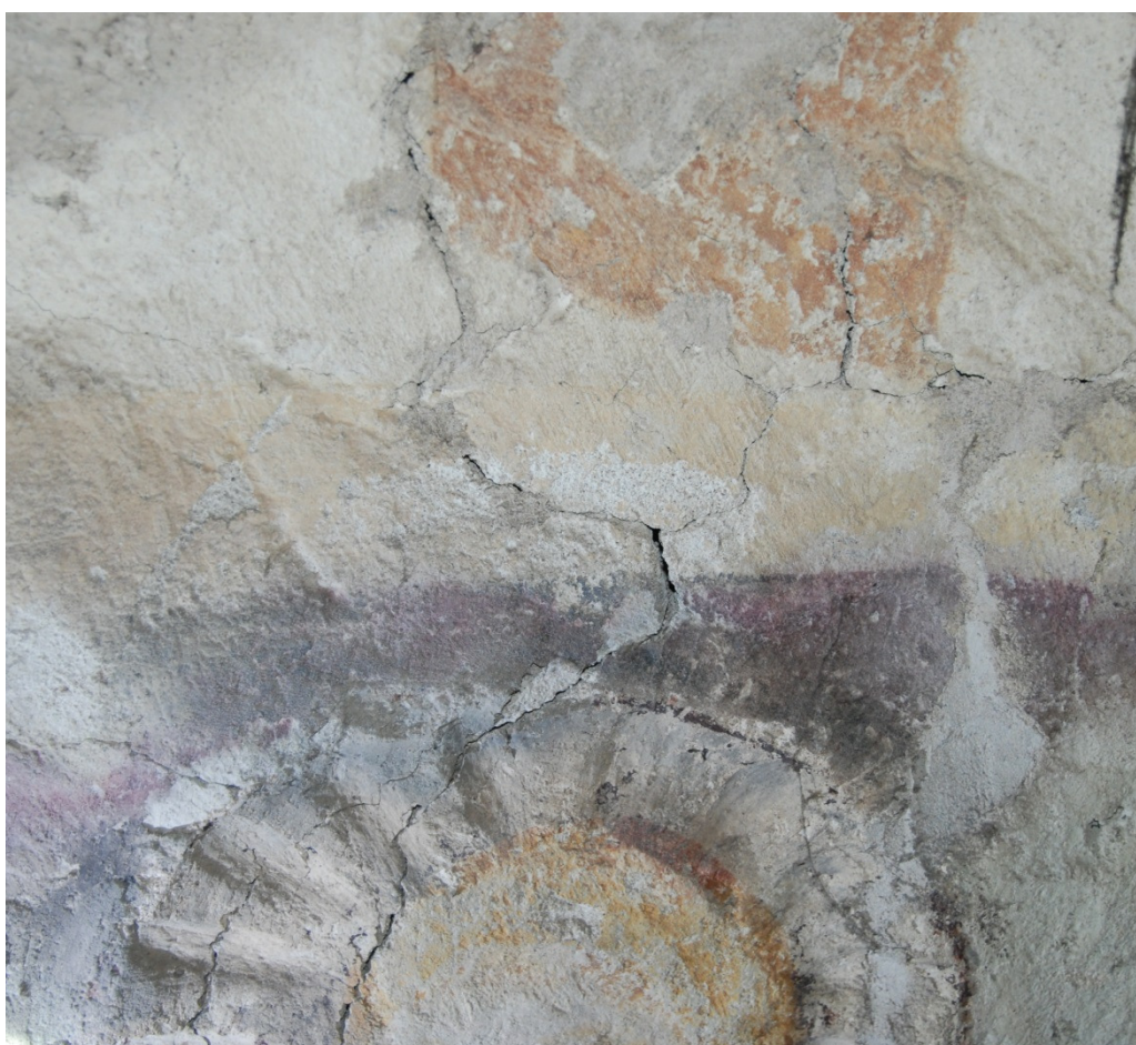
Samma figur, skador i putsen ovanför.
