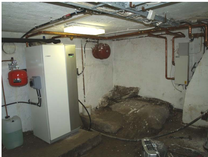
Yllestads kyrka bergvärmepump.
