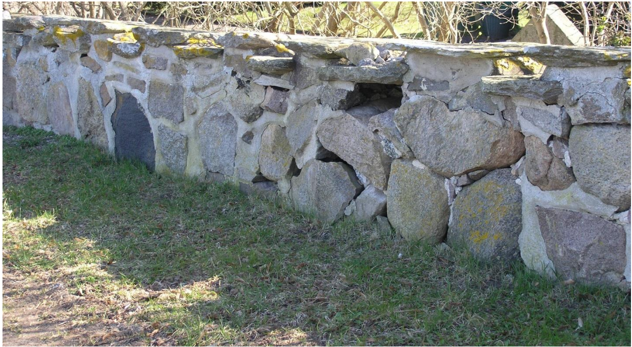
Kyrkogårdsmuren mot nordväst har stora skador p.g.a. de omgivande lindarnas rottillväxt. Skadorna är omfattande och en riskfaktor som bör åtgärdas snarast.
