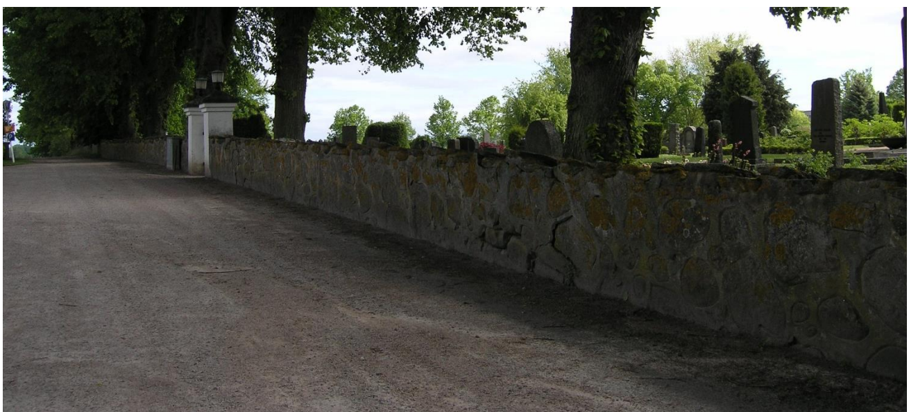
Kyrkogårdsmuren som är fogad med fältsten och sprängsten av granit, gnejs och diabas har sprickskador och utfallande stenar förorsakade av växande trädrötter. Parti av kyrkogårdsmuren mot väst.
