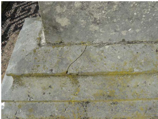
Genomgående spricka i gravsten samt mindre sprickor i sockeln.
