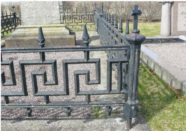
Gjutjärnsstaketet målas förslagsvis i samband med lagning av sprickor.
