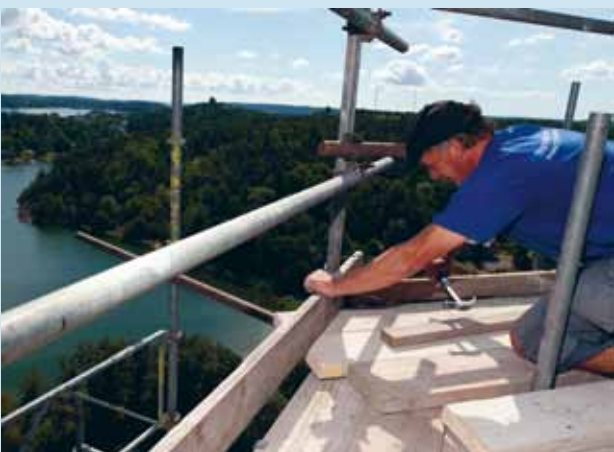
Torntaketets kopparplåtar har börjat lossna med risk för läckage och att de ska falla ned när det blåser. Hantverkarna är vana vid höjder men hoppas bli klara med arbetet innan höststormarna drar in.
