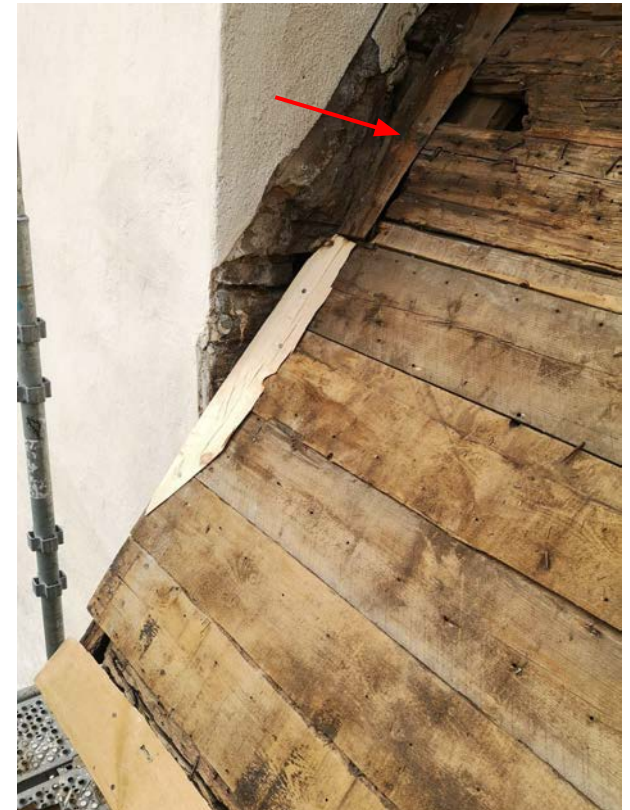
Fig. 22 Den Röda pilen visar den gamla kilen mot långhusets vägg.
