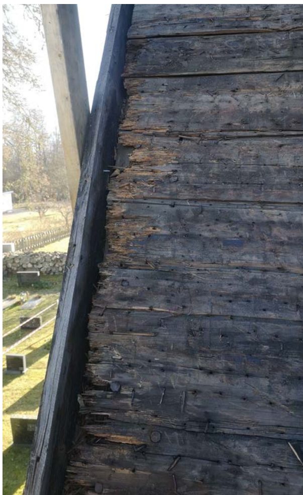
Fig. 39 Röttskada längst ut mot vindskivorna.
