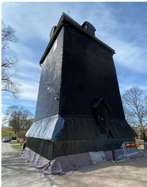
Klockstapeln har tjärats och dessutom har dess trappa lagats.
